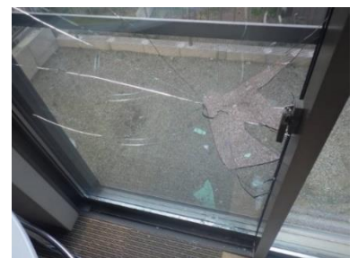
ガラスが破られた被害現場写真
